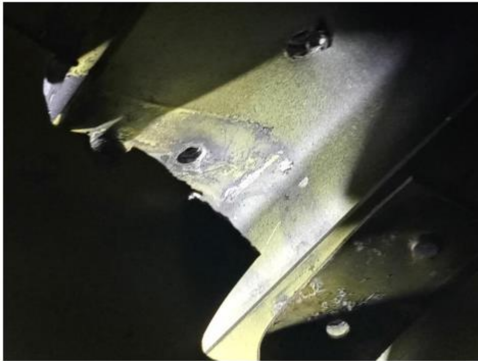
Figura N° 5. Fotografía de costilla afectada.
